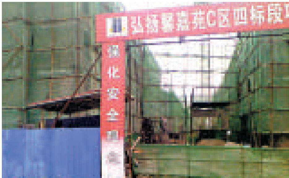
▲在建中的弘揚馨苑 ▲倒塌現場
