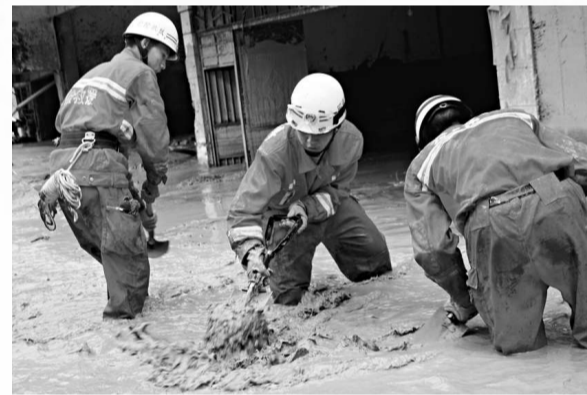
◀消防人員在雲南昭通市巧家縣小河鎮清理泥石流現場 新華社
