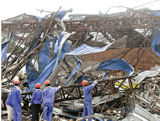
▲距離爆炸現場300米的一間物流公司被徹底毀壞，工人在清理廢房與貨物 陳旻攝
