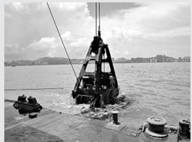
▲港珠澳大橋「島隧工程」今年12月底開建。圖為珠澳口岸人工島東護岸基槽挖泥現場 本報攝
