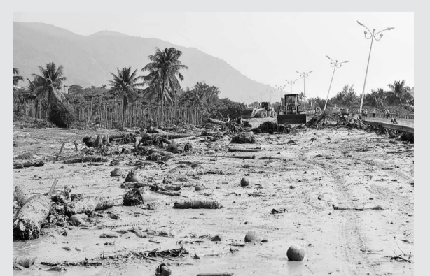
海南搶修東線高速公路 十九日，海南公路部門的工作人員正在清理路面。自十八日下午四時三十分海南東線高速公路因泥石流導致中斷後，公路部門抓緊清理、搶修公路，力爭盡早搶通。 新華社
