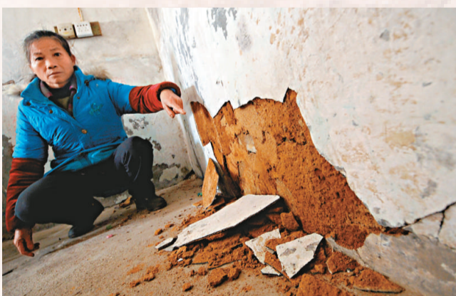
▲江西發生地質沉降災害。圖為會昌縣周田鎮新圩村村民羅鳳有指著家裏裂縫的牆壁
