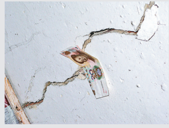
▲堯公寨村很多村民家裡的牆壁出現如圖所示的大裂縫，非常危險
