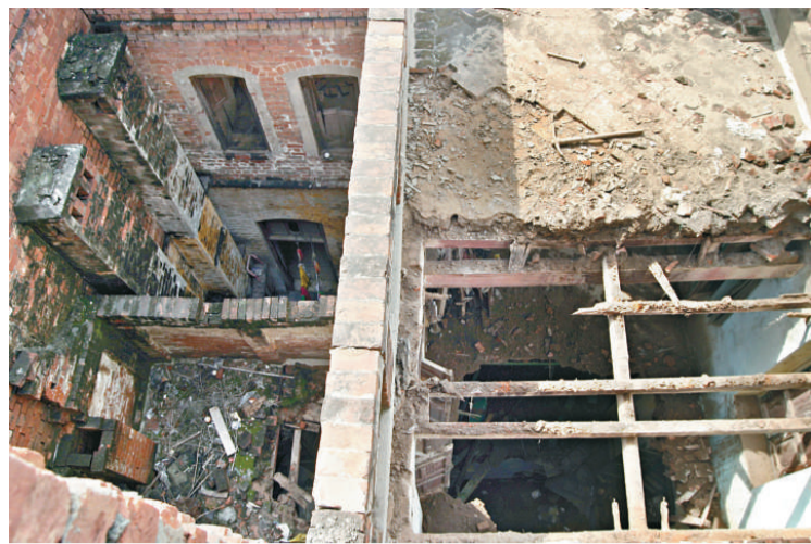
▲奎達的一棟建築在地震中嚴重受損
