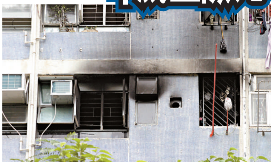
▲馬鞍山恒安邨發生火警單位外牆被熏黑
