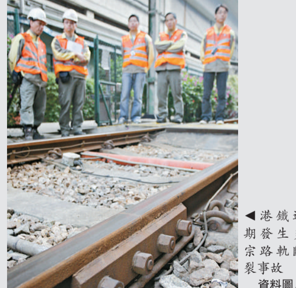
港鐵近期發生多宗路軌斷裂事故
