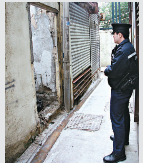
◀波油街唐樓閩門被盜現場 本報攝
