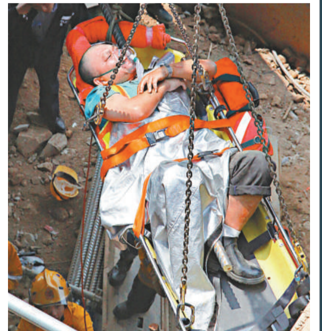
▲被鐵枝貫穿身體的地盤工
