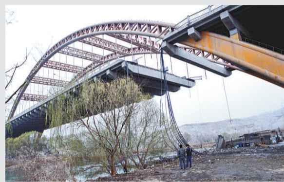
▲新疆庫勒勒克河大橋垮塌現場 新華社
