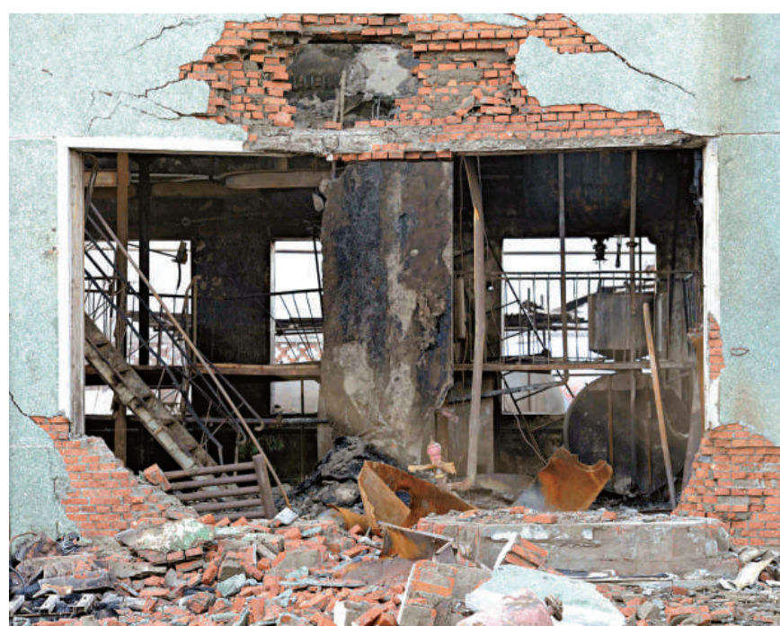
▲大慶一化工廠爆炸，廠房外牆全倒塌
