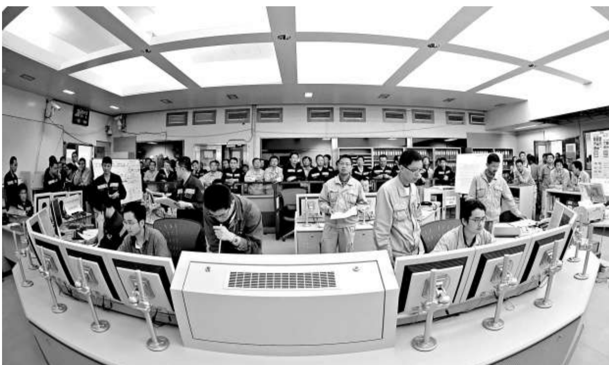
▲位於深圳大亞灣的嶺澳核電站控制室
