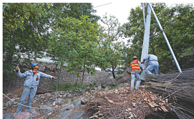
▲5月20日，國家電網公司天津蘇縣供電分公司員工在蘇縣黃崖關村進行架設施工。今年10月底，天津兩區三縣將在全國率先實現「縣縣電氣化」。新華社
