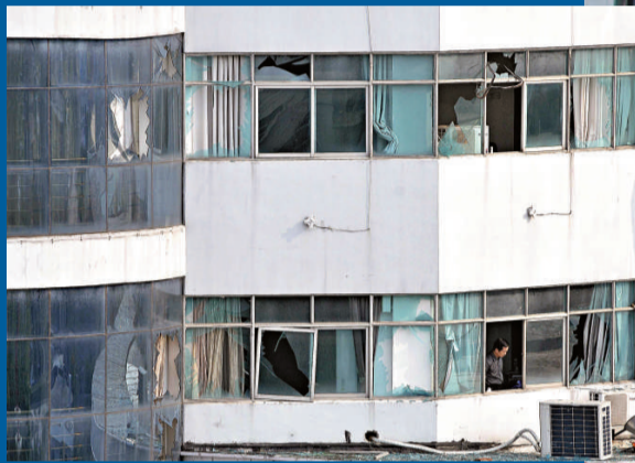
▲撫州市臨川區政府大樓窗戶被震碎 路透社
