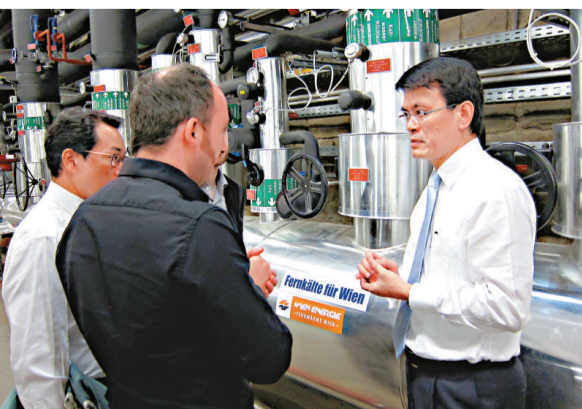
地先進的廢物管理設施。他早上在維也納參觀Spittelau焚化設施，了解該設施如何以先進焚化技術處理廢物，並透過轉廢為能產生電力。他還參觀了該設施的區域供冷系統（圖）。
