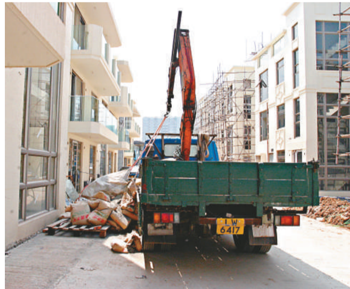
◀發生工人被英泥包壓傷的地盤
