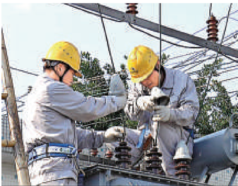
▲電力部門工作人員搶修電網確保正常供電
