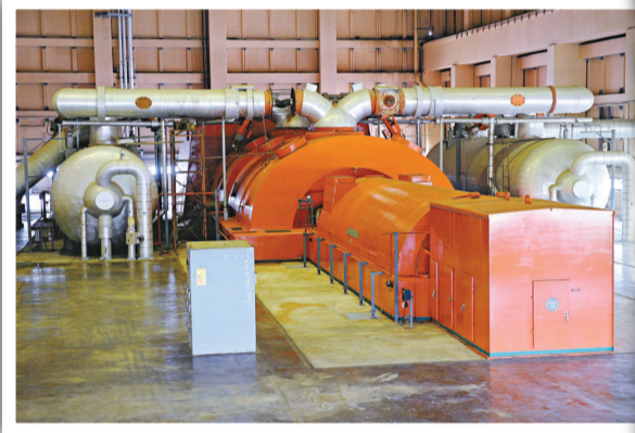
▶核電站內的交流發電機
