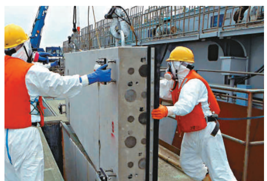
▲日本東電公司公布的照片顯示，上月12日在福島二號核電站，工人在安裝水泥板，以減少核泄洩對海水的污染 路透社
