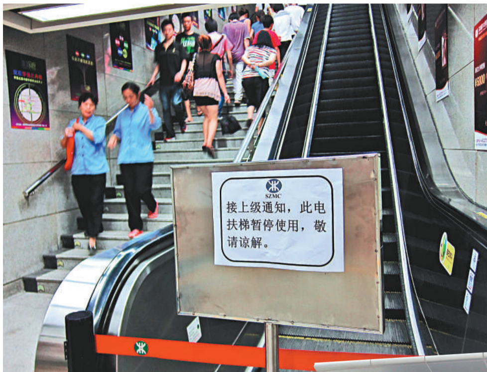
◀ 10日，深圳地鐵羅寶線華強站的電扶梯已經貼上暫停使用通知 新華社
