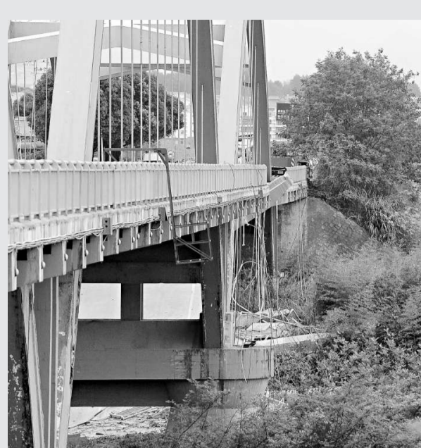
▲專家組對武夷山公館大橋垮塌事故進行調查得出結論，判斷事故原因主要是該橋長期超載造成吊桿「疲勞」斷裂
