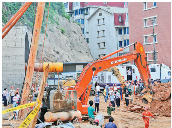
▲18日，救援人員在大連隧道塌方事故現場掘進救援通道
