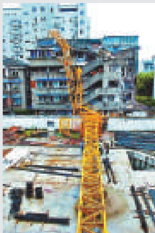
▲浙江省溫州發生吊塔坍塌事故，幾十米長的吊塔砸在民房上。網絡圖片
