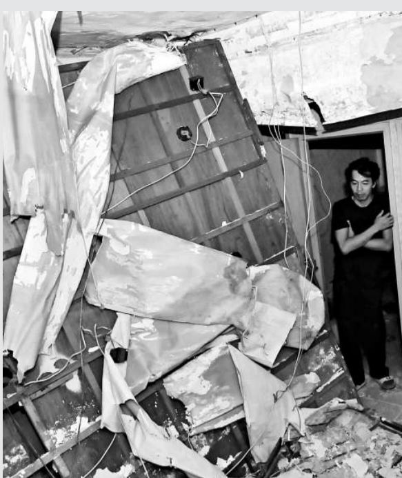
▲唐樓單位倒塌的天花
