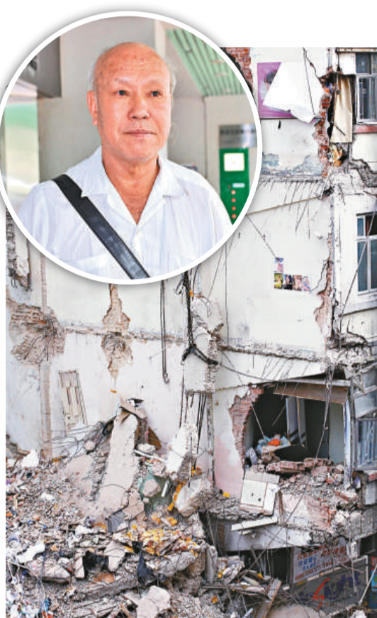
▲大廈工程承辦商朱偉榮（圖）說，塌樓前半年先後三次清理出一百袋批盪
