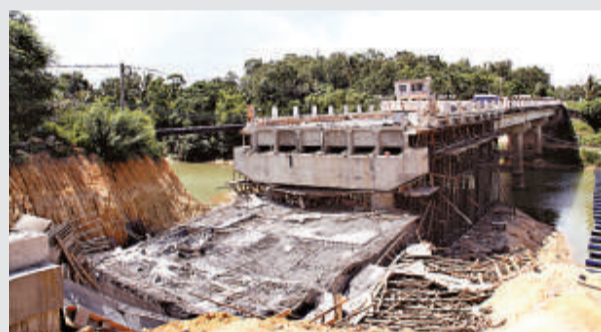
▲垮塌的太陽河大橋
