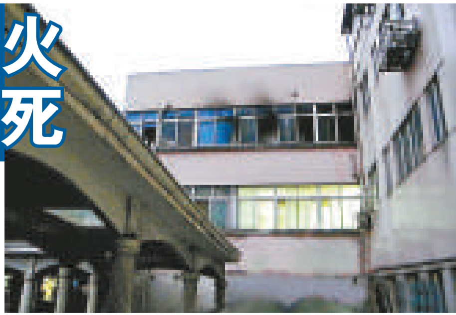
▲事發醫院外牆火災中被熏黑
