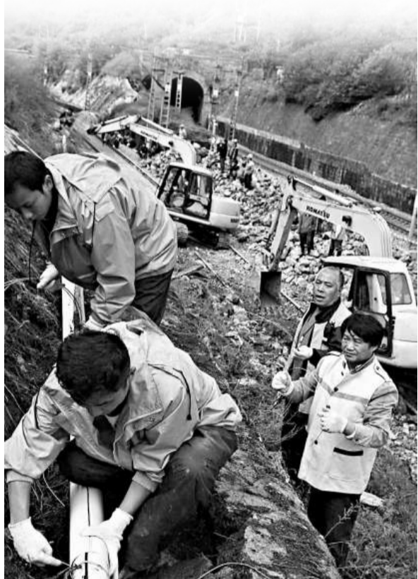
▲河南三門峽西隴海線塌方導致行車中斷，鐵道部門全力搶修
