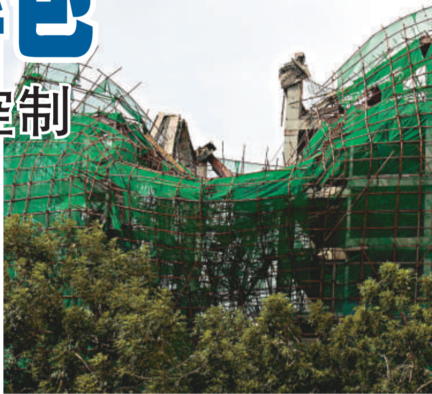
▲汕尾塌樓事故涉案的施工單位、承包單位以及包工頭約有10人被警方控制 呂劍攝
