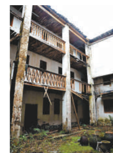
◀薛岳家祠目前已得到修繕（下圖），但由於缺少資金，薛岳故居還有許多建築破敗不堪 網絡圖片
