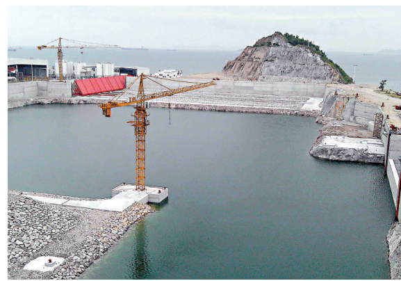
▲位於大橋沉管預製廠的深、淺場，將作為沉管管節舾裝、繫泊、出運通道，圖為深場蓄水試驗 本報記者方俊明攝
