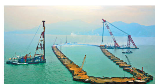
▲以鋼筒為基礎的人工島建設，是港珠澳大橋工程關鍵性項目
