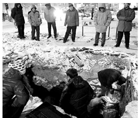
▲因哈爾濱市南崗區文景街一處熱源廠，供熱管網因承壓過重出現洩漏，導致23354戶居民供熱受到影響。經過搶修，三日十八時逐步恢復供熱。圖爲供熱受到影響的部分居民在施工现场焦急地等待搶修結果
