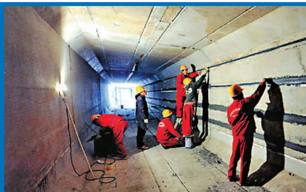
▲大連市東港新區地下綜合管廊，總長十三公里，是內地最長的地下綜合管廊。網絡圖片
