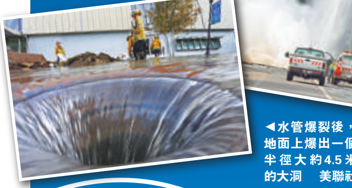
▲水管爆裂後，地面上爆出一個半徑大約4.5米的大洞 美聯社
