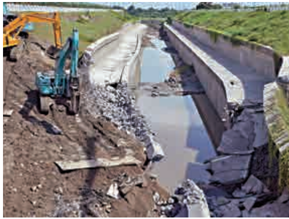
▲台南市港尾溝溪疏洪道啓用不到20天已經崩塌 中央社
