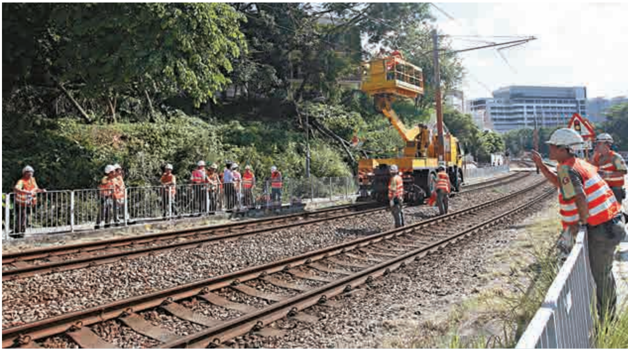
▲輕鐵路軌旁斜坡大樹倒塌，意外壓毀電纜，工程人員忙於鋸樹搶修 本報記者麥國良攝
