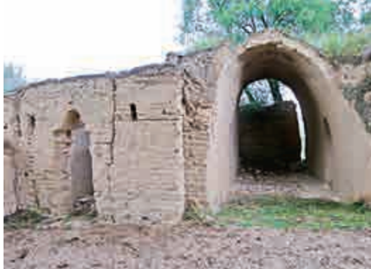
▲傳統生土建築在力學和耐久性有缺陷
