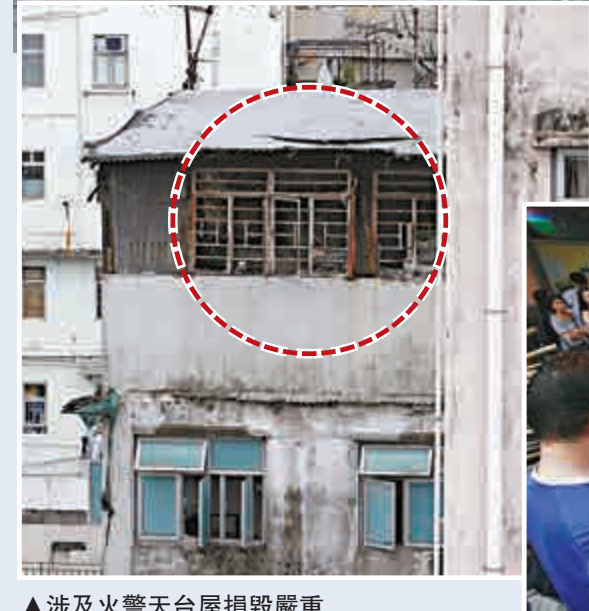
▲涉及火警天台屋損毀嚴重
