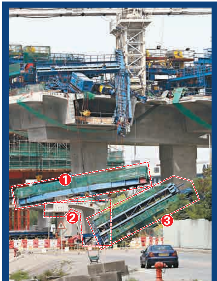
▲發生意外的港珠澳大橋地盤,事後暫時停工
