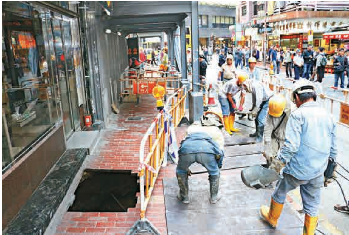
▲銅鑼灣路陷現場，工人搬運鋼板遮掩路陷洞口
