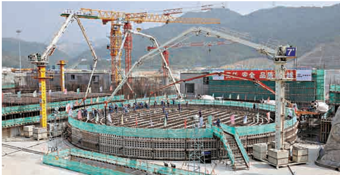
▲2014年8月，陽江5、6號機組棒控棒位系統正式簽訂供貨合同，採用國產百萬千瓦級壓水堆核電站控制棒驅動系統。圖為建設中的陽江核電站6號機組
