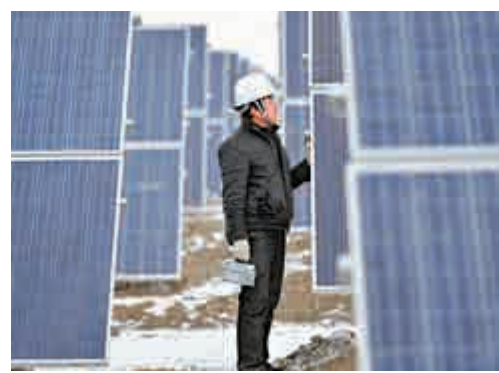
▲技術人員在甘肅阿克塞光伏發電基地檢查設備 新華社
