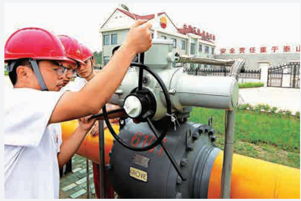
◀西氣東輸二線香港支線管道工程已通過專項驗收。圖為工作人員打開江蘇南通供應天然氣管道控制閥開始輸氣 資料圖片
