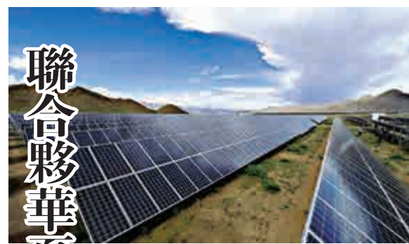
▲聯合光伏彩華夏人壽建設太陽能電站
