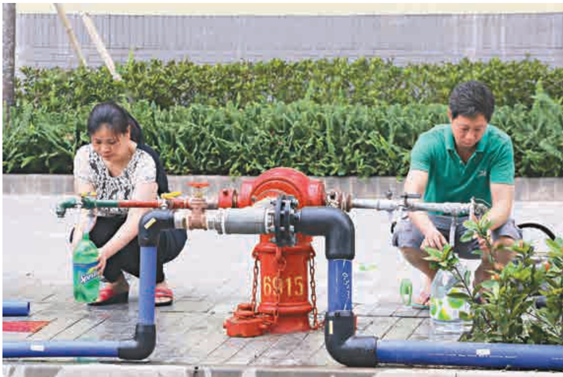
▲水務署除在邨內增設水箱及水車，讓居民取水，同時加裝臨時供水系統 大公報記者黃洋港攝
