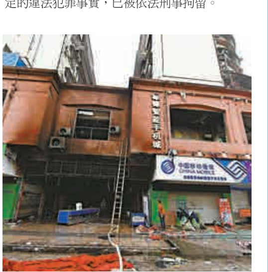
▲福建寧德起火幼兒園未通過消防驗收 新華社
